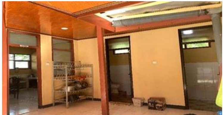
Gambar 1.3 Kondisi Dapur dan Kamar Mandi
