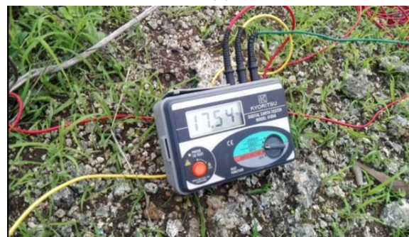
Gambar 1.9 Hasil Pengukuran Tower 77 Menggunakan Earth Tester Kyoritsu 4105A
