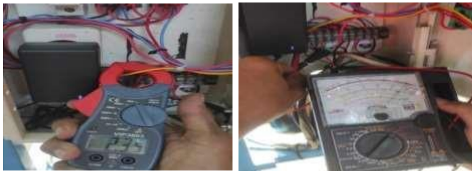
Gambar 4. Hasil pengecekan Ampere dan Voltase Pada motor listrik
